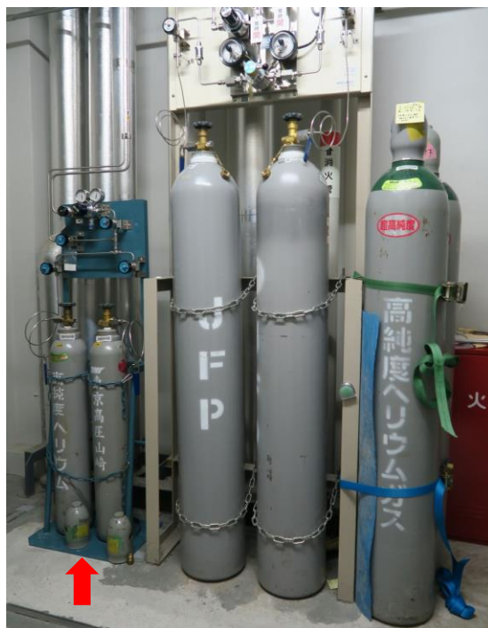
少量タイプのボンベも使用できるよう、ボンベ庫の配管を改良
