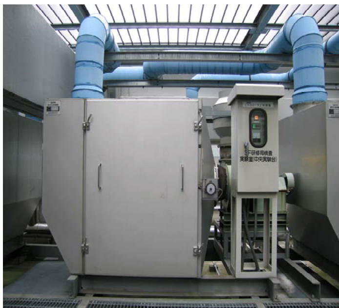
有機溶剤用脱臭装置
