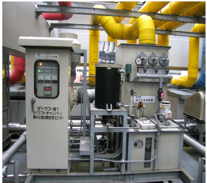
酸性ガス用排ガス浄化装置
