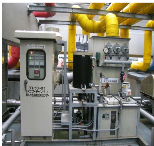
酸性ガス用排ガス浄化装置
