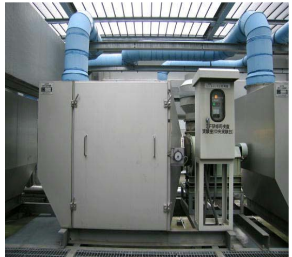
有機溶剤用脱臭装置
