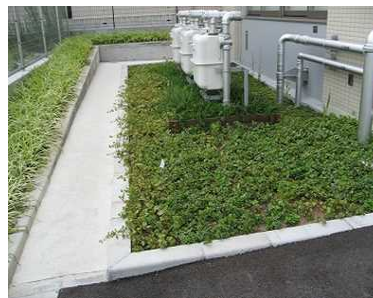
神戸センターガスメーター周り
