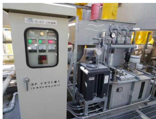
排ガス洗浄装置 (湿式スクラバー)
