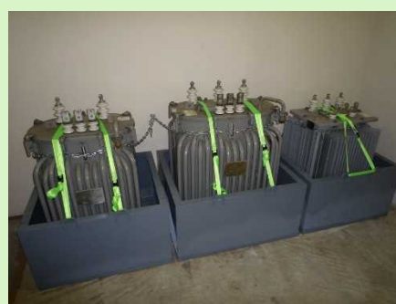
高圧トランス
