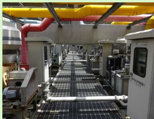
屋上スクラバー群 本部(屋上)
