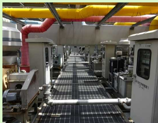
屋上スクラバー群 本部(屋上)
