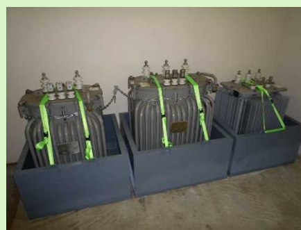
高圧トランス
