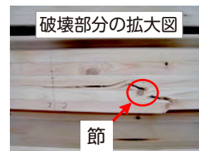
破壊部分の拡大図 節 木材が壊れる時には、節等の木目の乱れたところから壊れることが多く、このような木目の乱れは強度面ではマイナス要因とされます。
